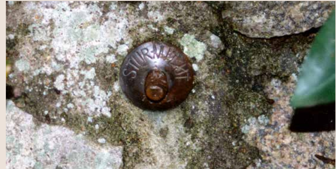
Hochwassermarken an der Prerower Friedhofsmauer, Foto: Antje Hückstädt
